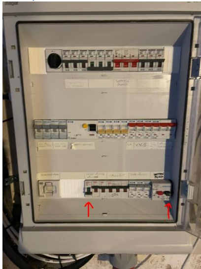
Figur 1 En av faserna i källaren på Huvudcentralen har gått, varpå vattenpumpen har stannat. Efter återställning av fasproppen måste vattenpumpen återställas med den svarta tryckknappen.
